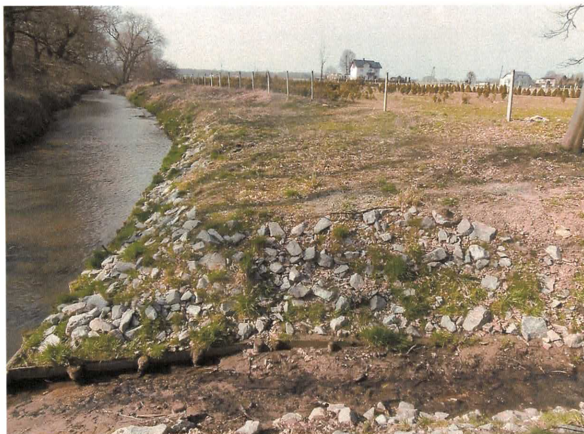
Leśnica wyrwa w lewym brzegu – przed i po konserwacji
