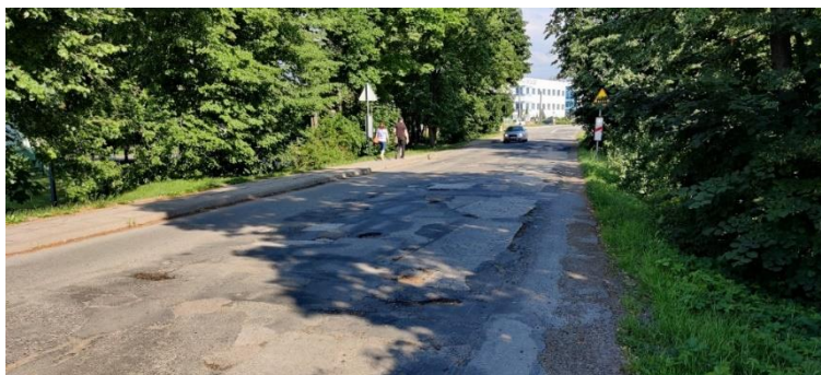
Zdjęcie 6 Droga powiatowa - ul. Górecka w Skoczowie przed przebudową
